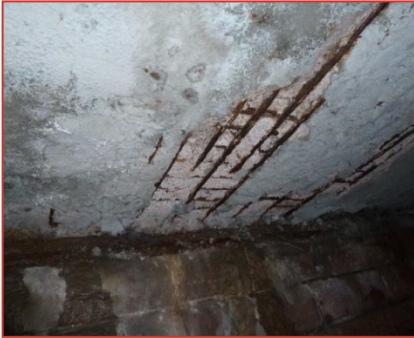
↑ PHOTO DE L'IMPACT DU MILIEU MARIN SUR UN BETON NON SPECIFIQUE
